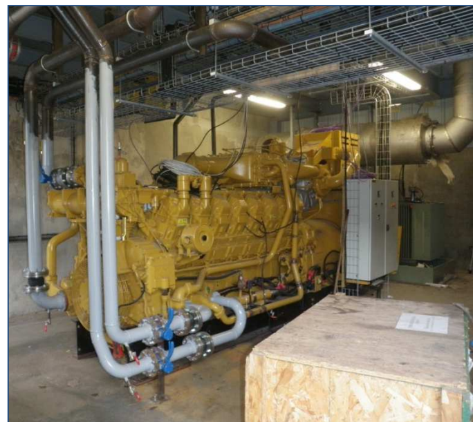
Vue d'un des 2 moteurs actuels
